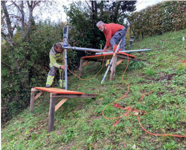
Schraubfundamente können problemlos in Hanglage montiert werden
