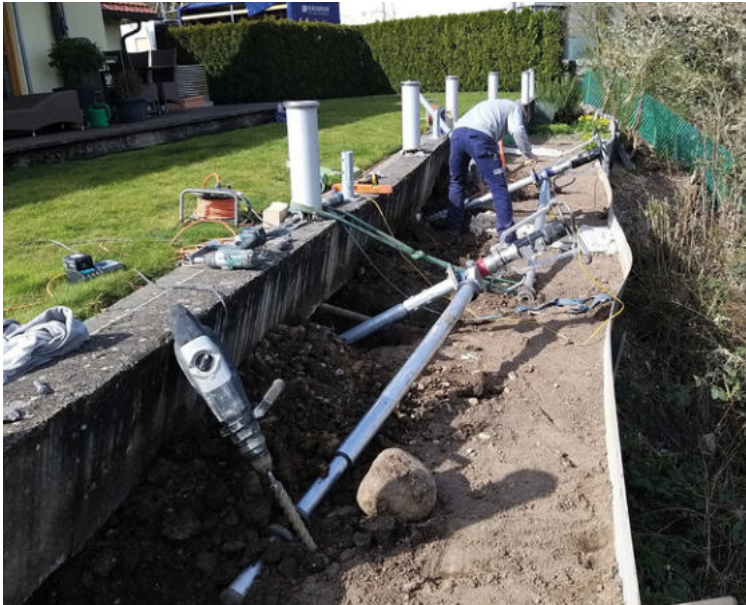
Absenkender Boden Am Einfamilienhaus
