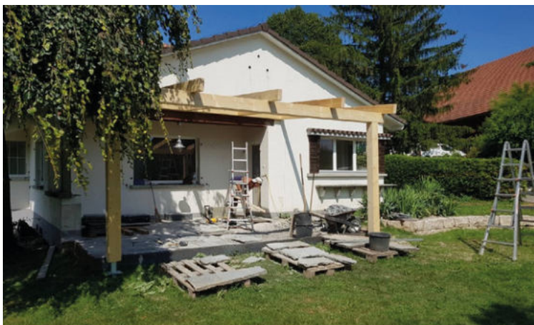
Pergola mit eingespannten Holzstützen
