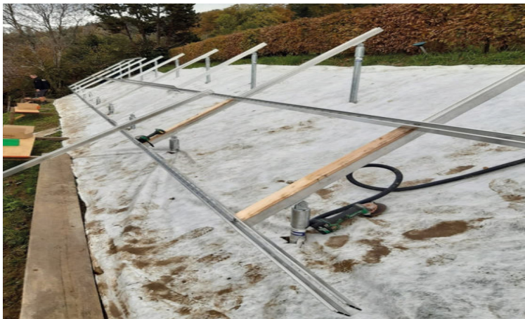
Das Stahlgerüst bietet ein einfaches und festes Fundament für Solarpanels
